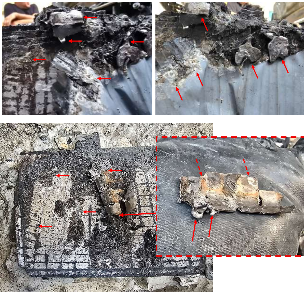
Figura 45 a 47 – Setas vermelhas mostram placas positiva e negativa, com vestígios compatíveis com falha eletroquímica severa na bateria chumbo-ácido , associada a sobrecarga elétrica . As placas positiva e negativa apresentarem danos por queima, fragmentação e pontos de fusão indica que o sistema foi submetido a
