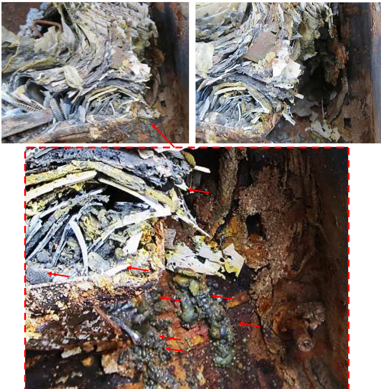
Figuras 24 e 25 – Setas vermelhas mostram vestígios nas placas de chumbo, vasos e células dos polos positivo e negativo, apresentando danos por derretimento completo, gerando de nucleação nas placas de chumbo e conectores, decorrentes de curto-circuito interno, bem como material esbranquiçado na superfície, oriundo da sulfatação das células e do material eletrolítico.
